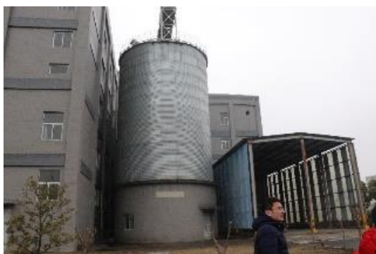
整改前原料筒仓（未密封收集颗粒物）
