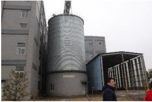
整改前原料筒仓（未密封收集颗粒物）
