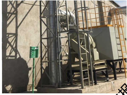
218 酿酒车间废气标识牌 (2#)
