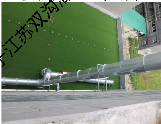
整改后颗粒物收集输送管道
