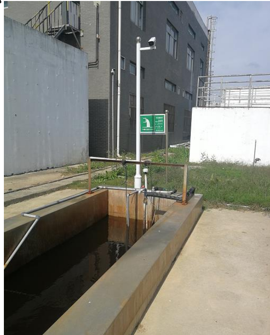
新区污水处理站排水口
