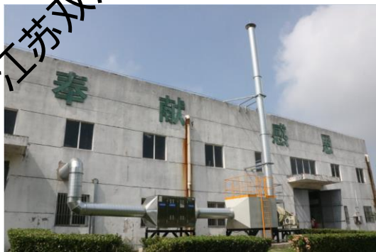
218 酿酒车间废气治理措施 (1#)
