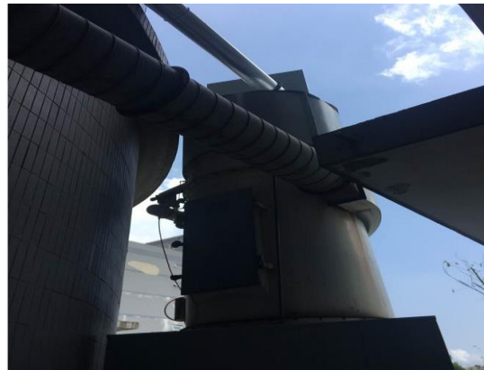
整改后原粮输送及除杂旋风除尘器
