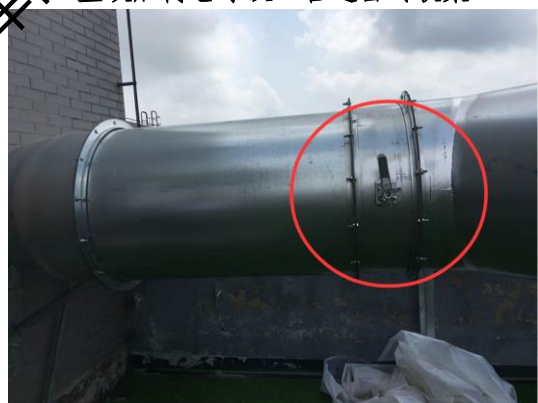
整改后颗粒物废气控制阀（针对筒仓）
