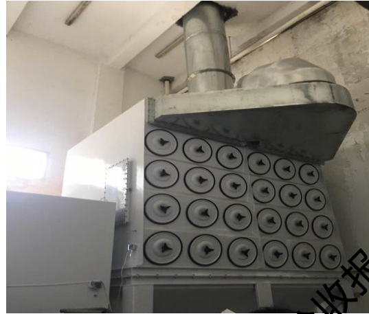
整改后初效+中效+高效除尘设备
