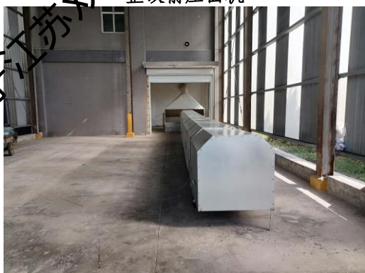
整改后筒仓原粮配料密闭输送及收集
