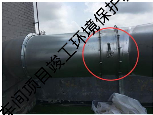
整改后颗粒物废气控制阀（针对筒仓）
