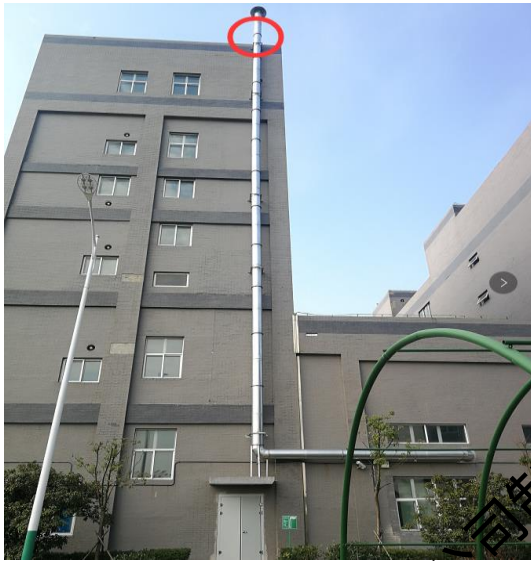
整改后颗粒物排气筒采样口
