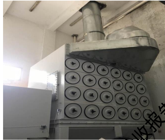
整改后初效+中效+高效除尘设施
