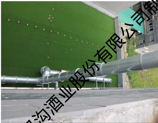
整改后颗粒物收集输送管道
