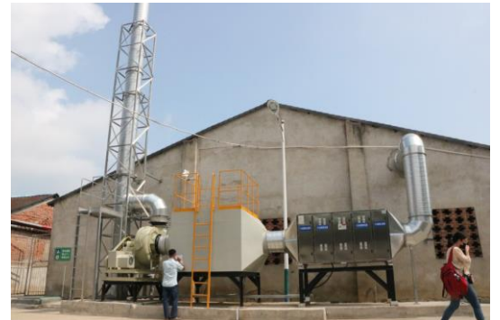
218 酿酒车间废气治理措施 (2#)
