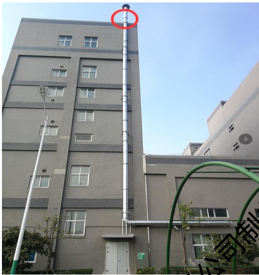
整改后颗粒物排气筒出口
