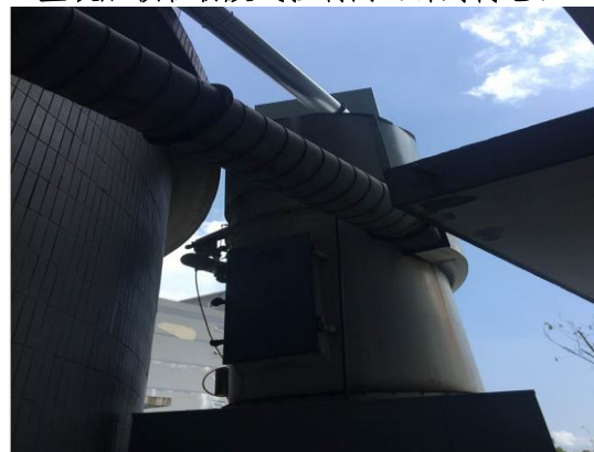
整改后原粮输送及除杂旋风除尘器
