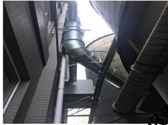
整改后原料筒仓及输送除杂颗粒物收集管道
